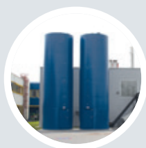
Silo en acier
