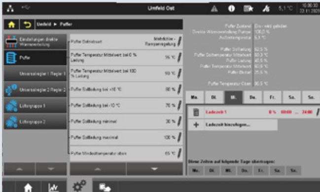
Umfeldeinstellungen der Pufferspeicher
